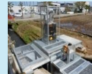
小水力発電施設
